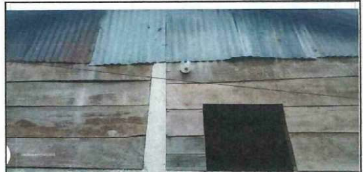
fotografia de ventana a reparar
