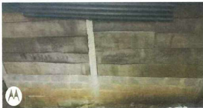
Foto 3: Sustrucción de madera por block
